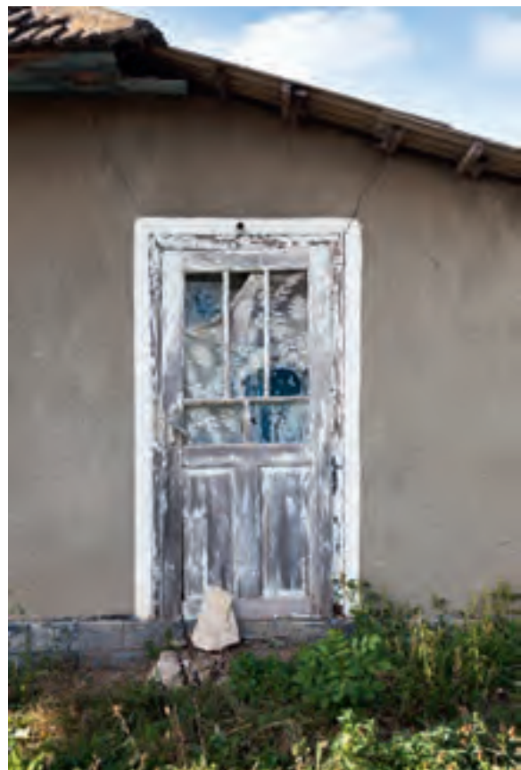
Verriegelter Eingang eines verlassenen Hauses in Slobozia-Șirăuți. (Foto: Anja Schäfer)
